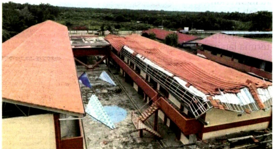
Keadaan bumbung SMK Seri Menanti yang runtuh kelmarin.
